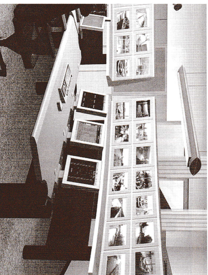
Steuerstand für die Schleusenfernbedienung
